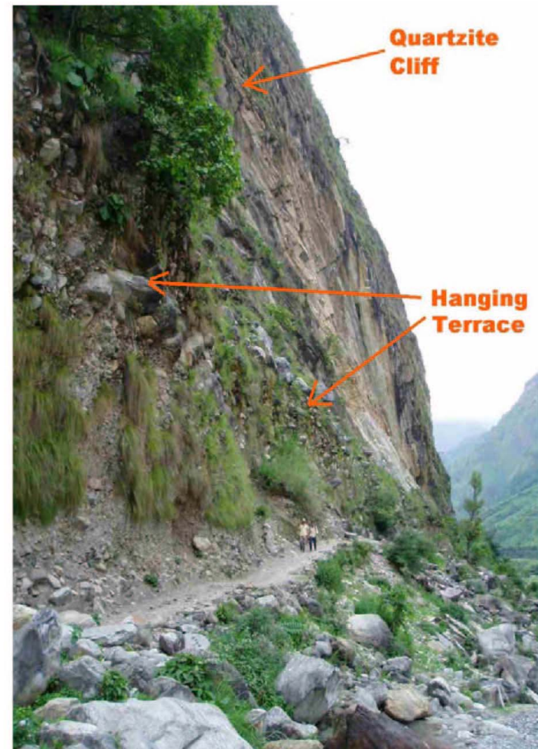
図6. テラスの残骸が巨大急峻なコーツアイトの大岸壁の途中にひっついていて、下を通るトレッキングコースは危険である(ジオサイト1B)
